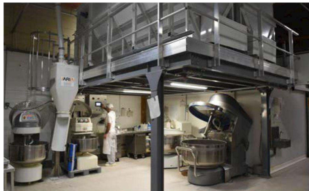
Les deux silos Aria Constructeur sont associés à l'outil de pilotage DOFAO pour doser l'eau et la farine.
